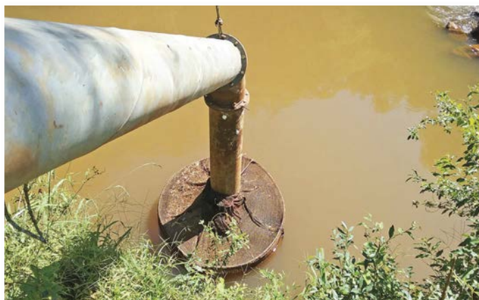
► Figura 4. Tela protetora na entrada da tubulação de captação de água, impedindo a sucção de alevinos.
