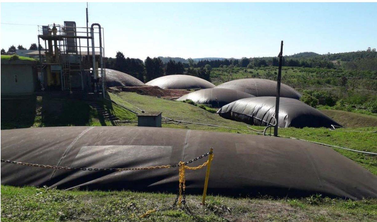
Figura 16. Biodigestores de lona e equipamento gerador de energia elétrica (à esquerda).
