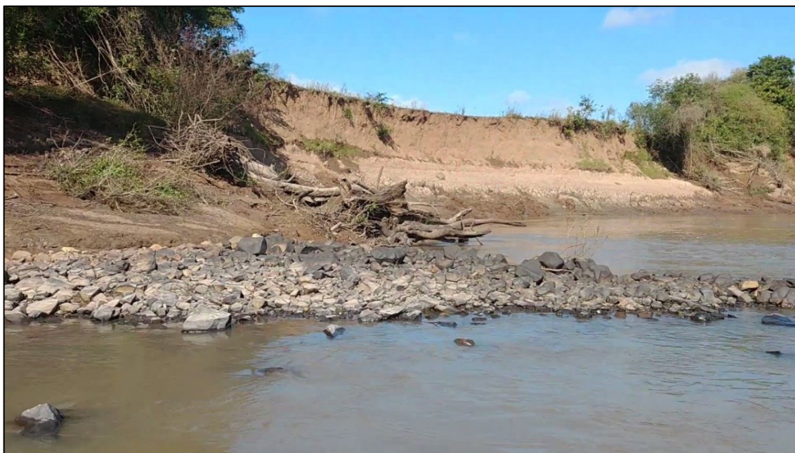
Figura 4.6 – Ponto 84 na margem esquerda (margem erosiva) onde se observa o dique em primeiro plano e a margem com erosão da margem e sem vegetação na porção erodida.
