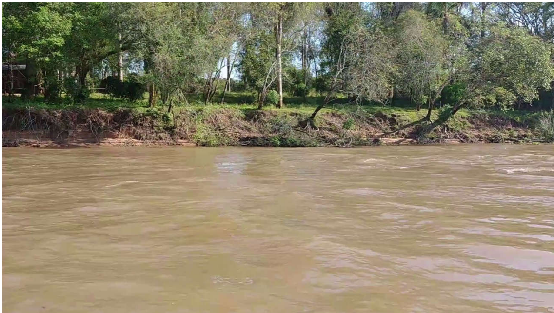
Figura 3.265 –.Margem esquerda, aproximadamente 300 metros da jusante do ponto 271, processo erosivo em margem ocupada e com pouca vegetação.
