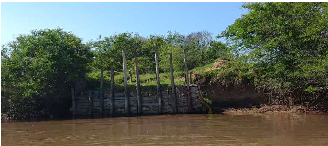
Figura 3.276 – Sequência da figura anterior, 20 metros a jusante. Talude entre 1,5 e 2 metros de altura com uma contenção para erosão do mesmo.
