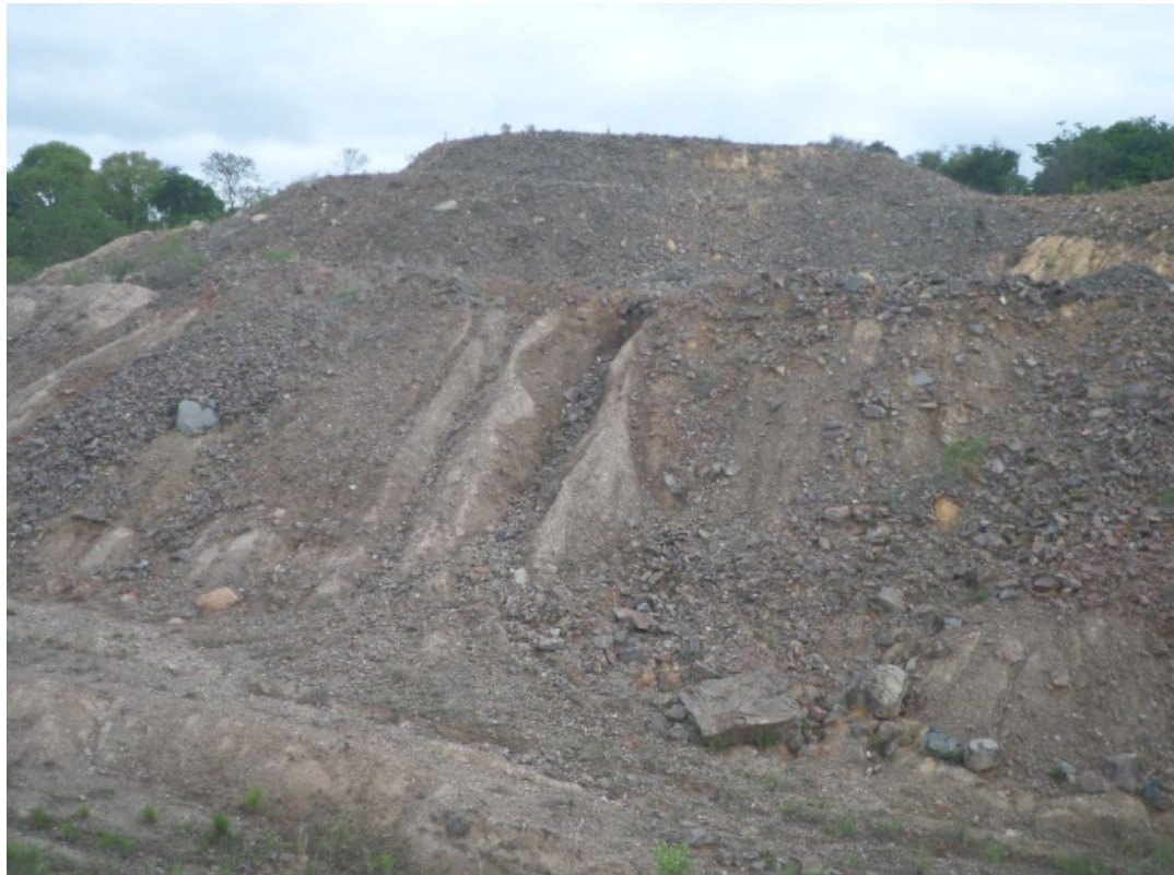
Figura 4 - Tentativa de escalonamento de parte dos taludes de aterro, Pedreira Buriti (29°05'18.47"S, 53°15'51.54"O), Salto do Jacuí, RS. Data: 17/12/2015.
